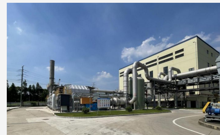
RTO 设备装置
